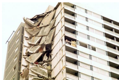
شکل ۱- خرابی پیش‌رونده در ساختمان رونان پوینت
